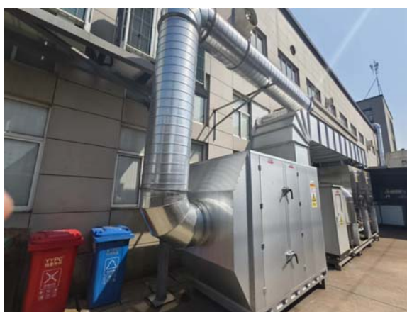
废气处理设施
