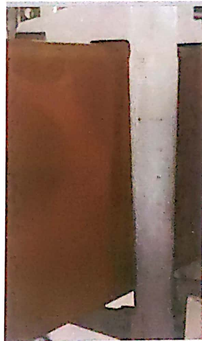
主母排宽度照片
