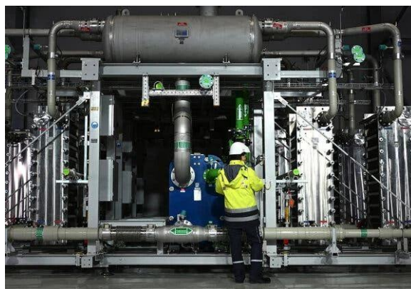
德国未来氢气生产设施的电解槽
