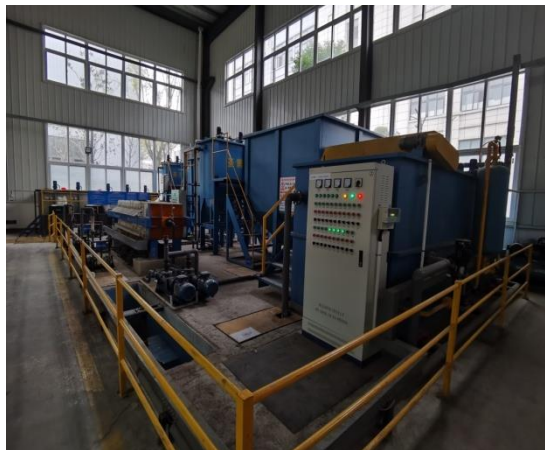
项目设置的生产废水处理设施
