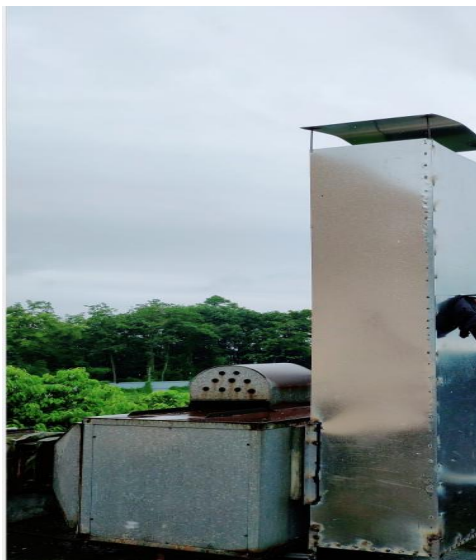
食堂油烟净化器及排气筒
