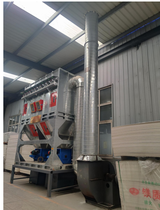
中央除尘器+排气筒
