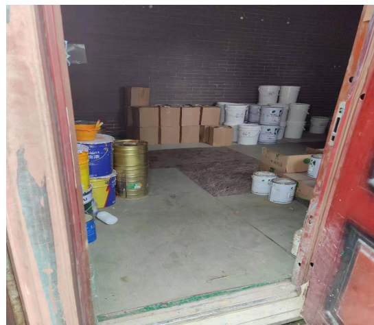
化学品库房防渗（防渗混凝土+环氧树脂漆+围堰）
