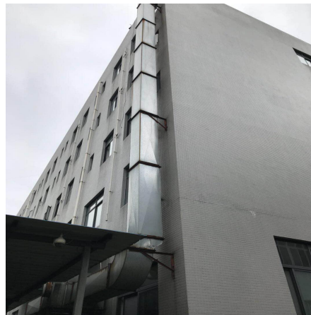
食堂油烟排气筒
