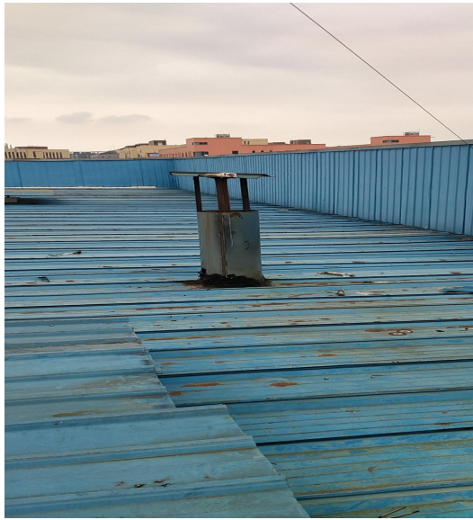
热风炉排气筒（检测孔位于下方）
