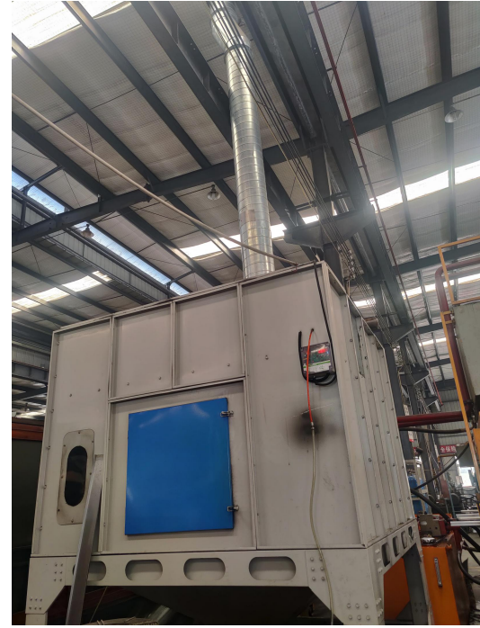
滤筒式除尘器+排气筒
