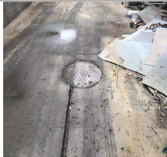
生活污水排口
