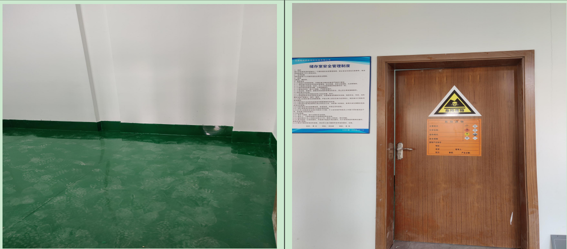
危废暂存间（防渗措施及标识标牌）
