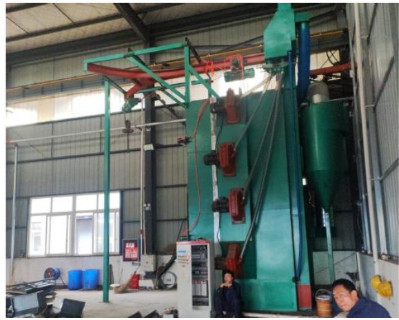
抛丸粉尘经脉冲滤芯除尘器处理
