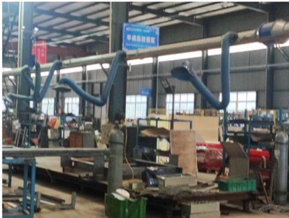
焊接工位配置侧吸式集气罩
