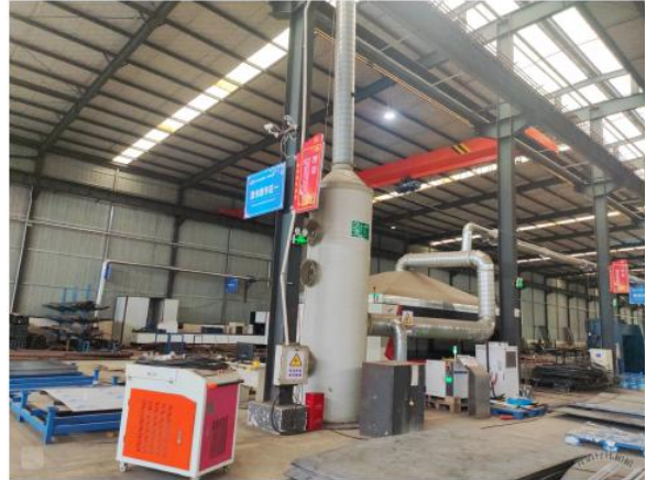
切割烟尘和焊接烟尘汇至水喷淋塔处理
