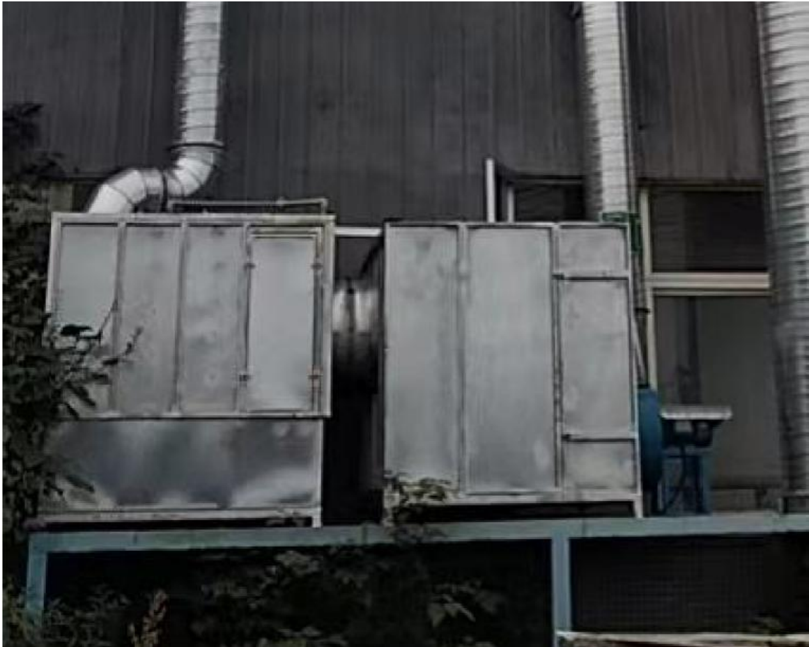
二级活性炭处理装置
