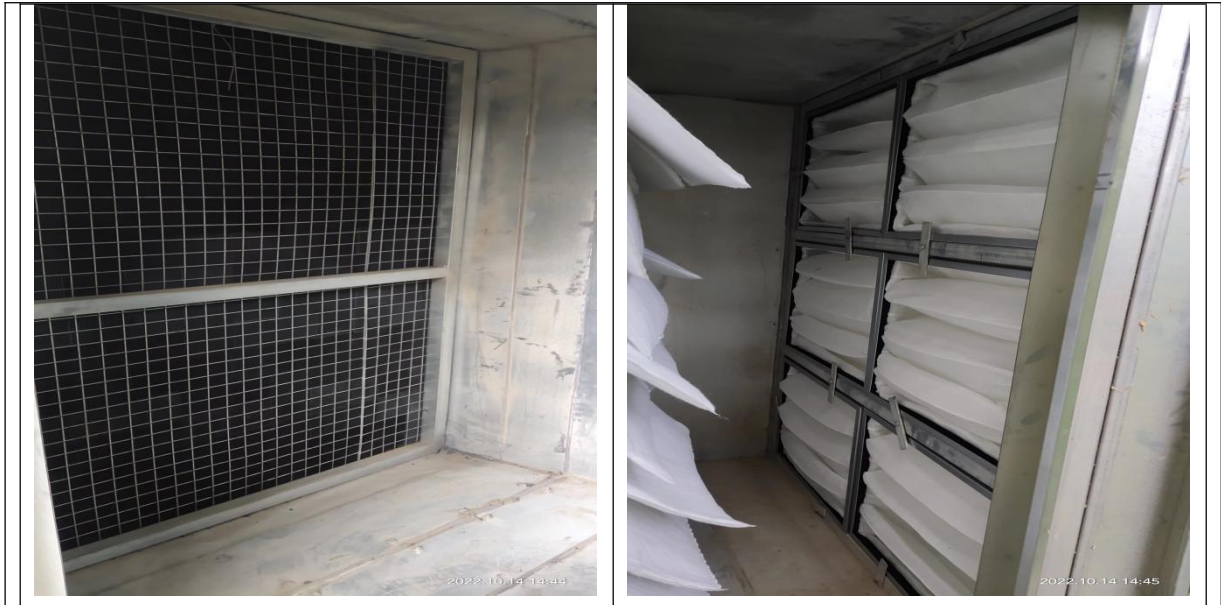
二级活性炭装置内部照片
