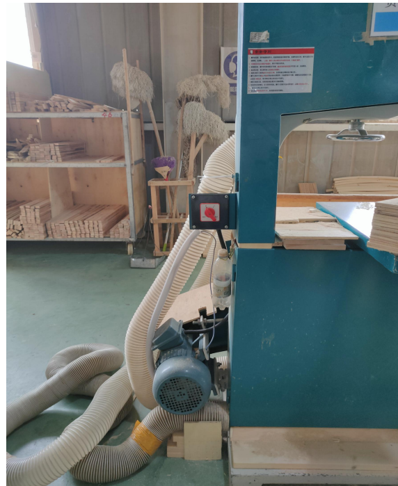
下抽风管收集措施
