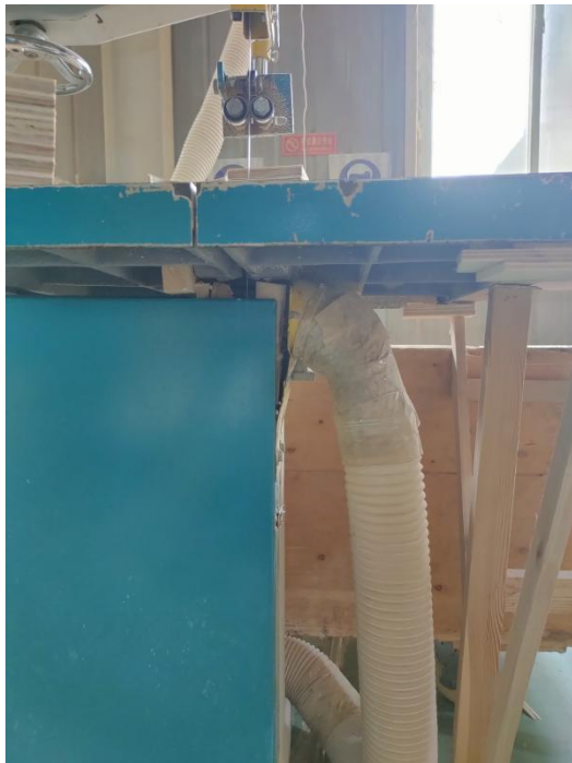
下抽风管收集措施
