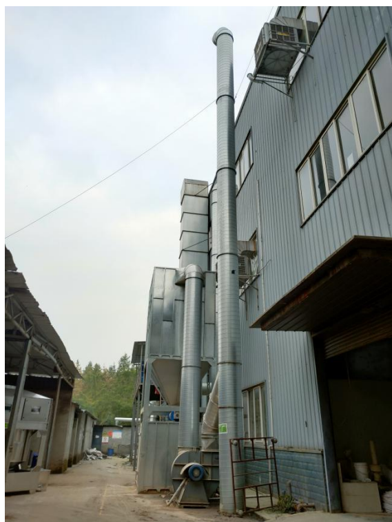
中央除尘器及对应排气筒（DA001）
