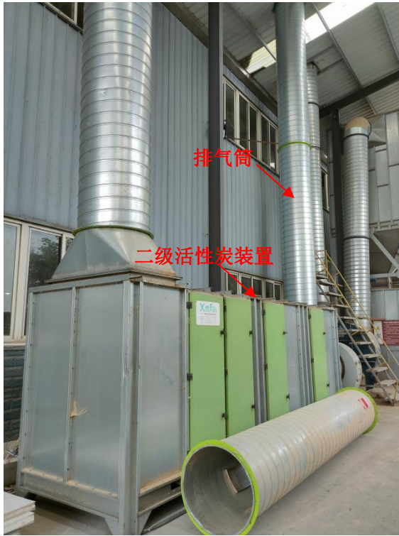
二级活性炭装置及对应排气筒（DA003）
