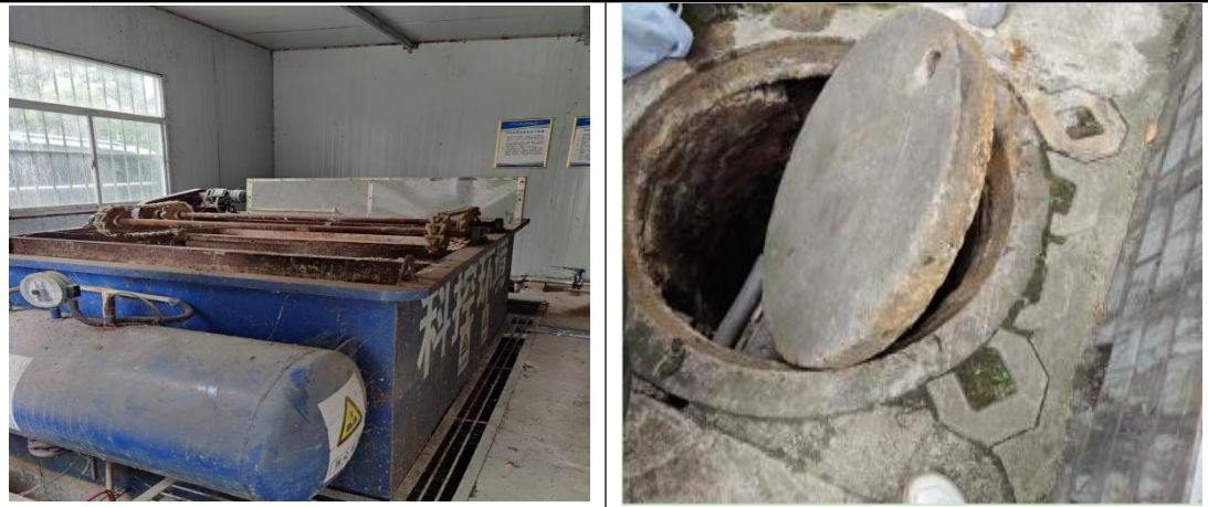
污水处理站及总排口
