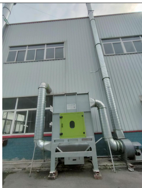
耐高温布袋除尘器及 2#排气筒
