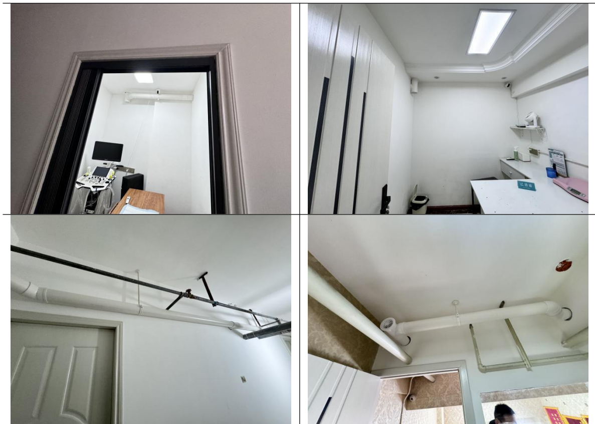
废气收集管道
