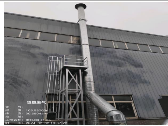
DA008 喷塑排气筒
