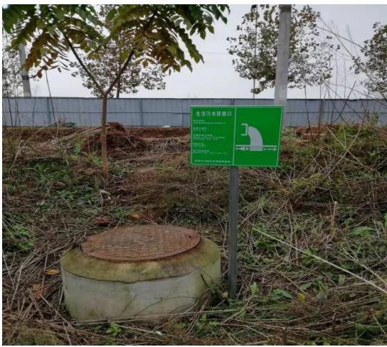
生活污水预处理池+排口（地埋）
