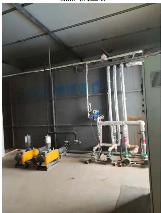
污水处理设施
