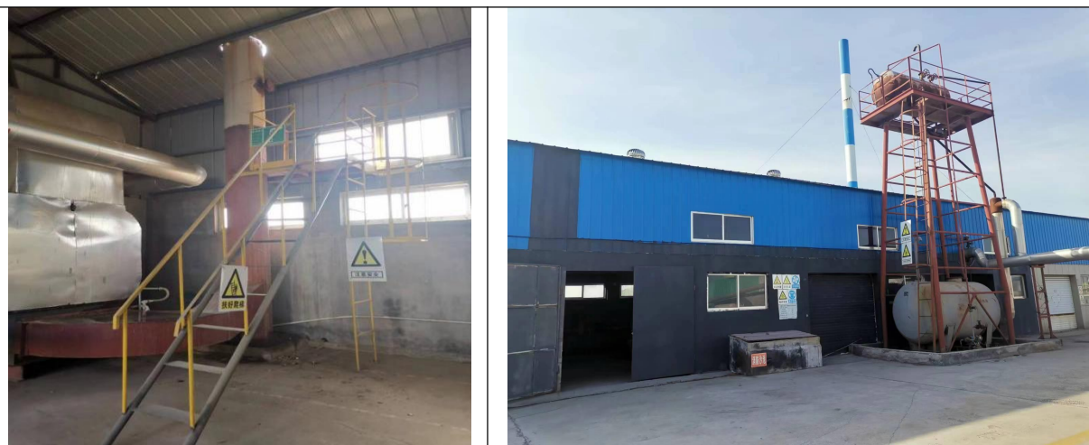
导热油炉排气筒 DA002
