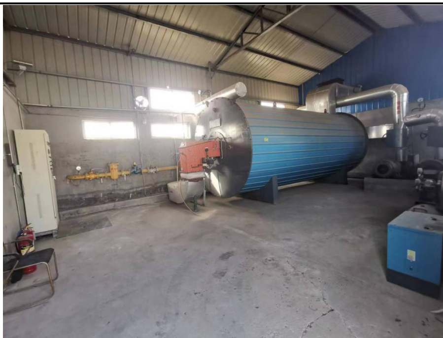
生产车间内部
