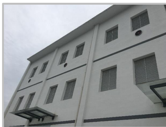
通风换气设施
