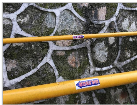
天然气供气管道
