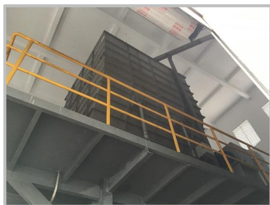
脱水污泥储存仓(地上式)
