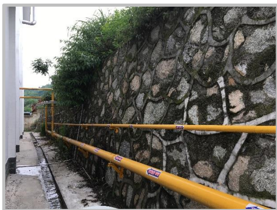
天然气供气管道
