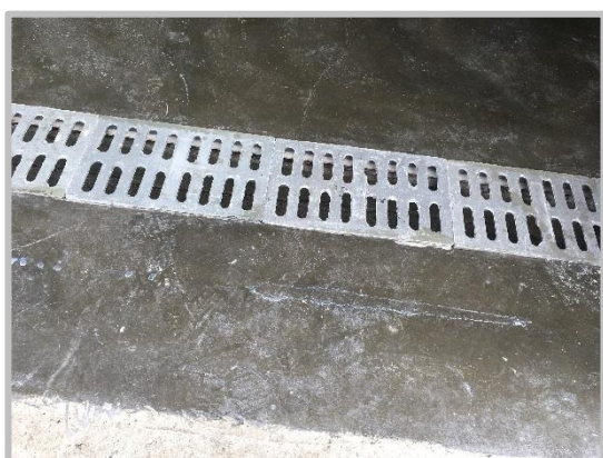
冷却水收集系统
