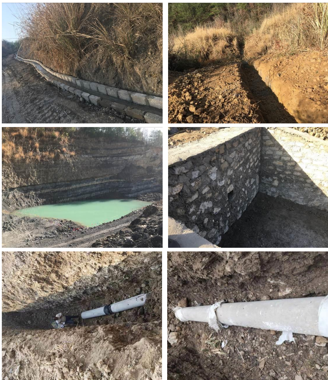
图 4-8 项目雨水收集排放设施
