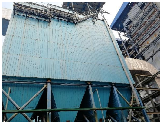
锅炉废气电袋除尘设施
