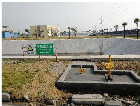
事故应急池进口及隔离闸门
