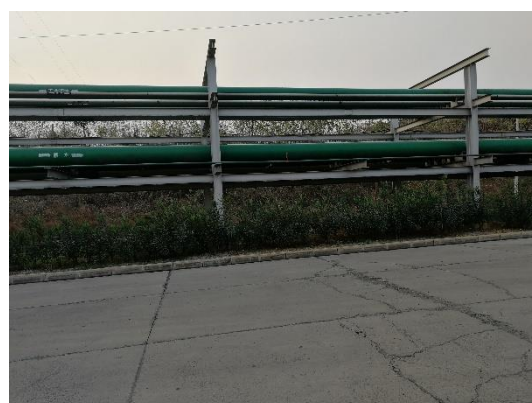
道路两侧喷淋设施
