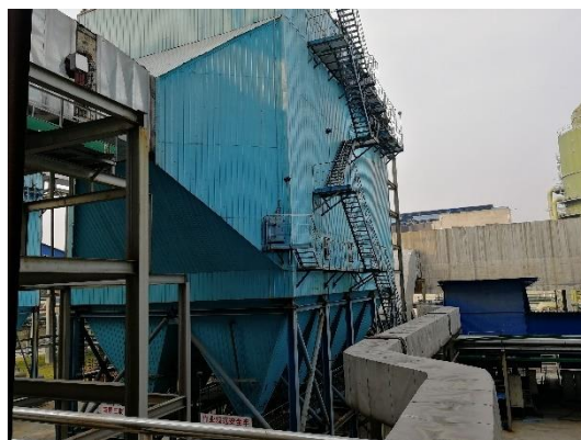
锅炉废气电袋除尘设施
