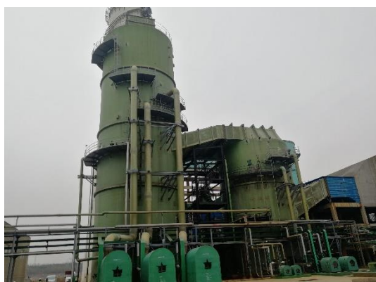
锅炉烟气脱硫系统
