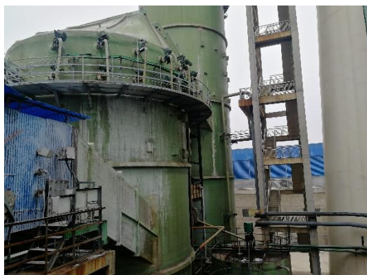
锅炉烟气脱硫系统
