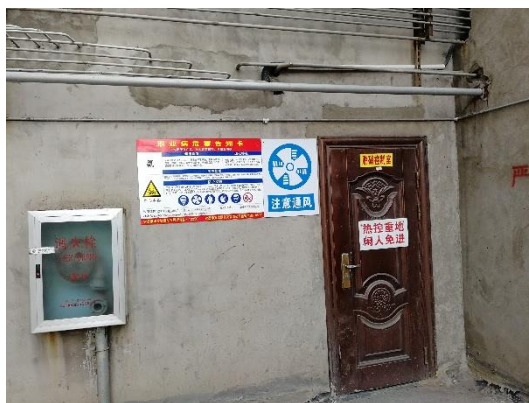
烟气脱硝控制室
