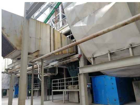
锅炉排气口消声器
