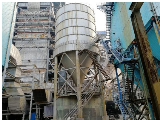
锅炉废气电袋除尘设施
