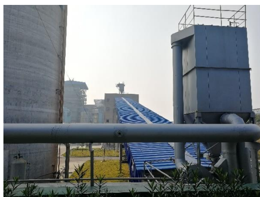
燃煤输送破碎废气袋式除尘器
