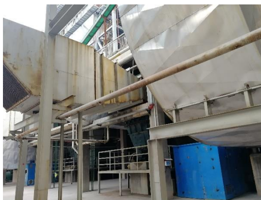
锅炉排气口消声器
