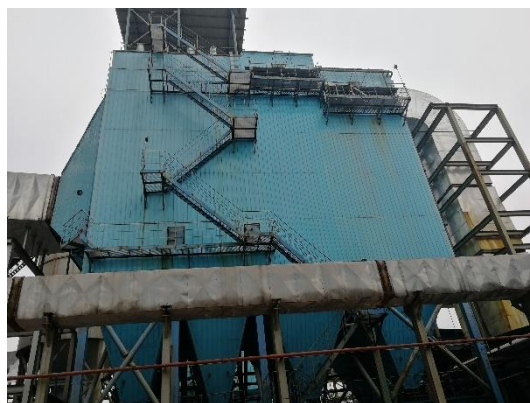
锅炉废气电袋除尘设施
