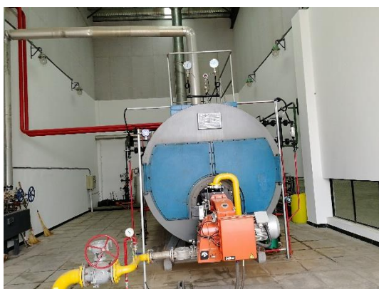
二期天然气锅炉
