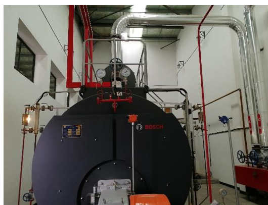
一期天然气锅炉
