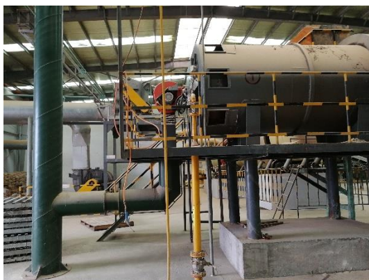
一期燃天然气热风炉
