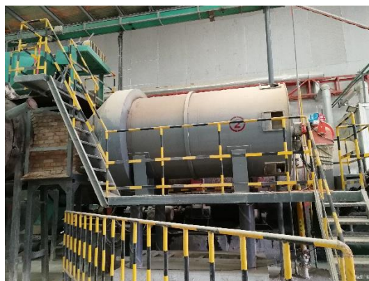
二期燃天然气热风炉
