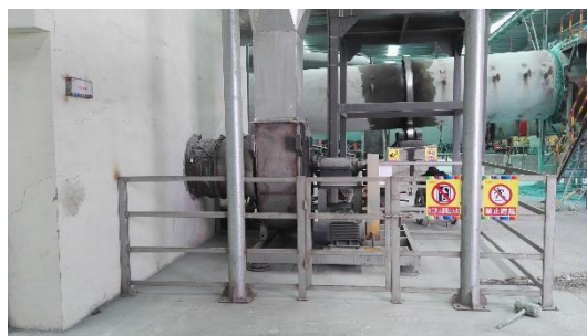
引风机减震、隔振措施
