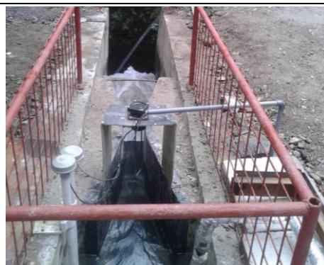
998 主平硐废水在线监测设施
