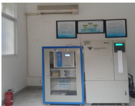
998 主平硐废水在线监测设施
