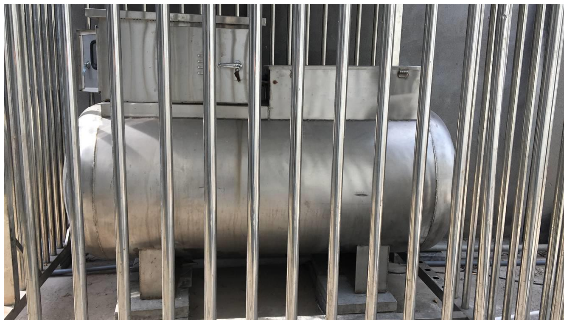
3t/d 的 NH-MBR 一体化膜处理装置
