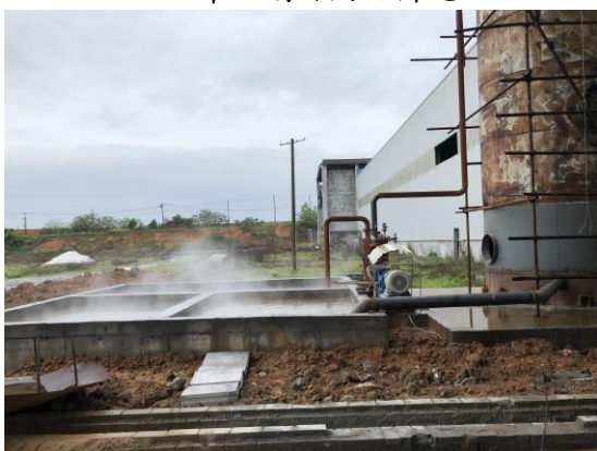
脱硫塔脱硫液循环池
