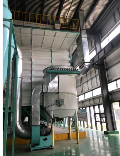
图 2-6 卸料粉尘排气筒 DA001
