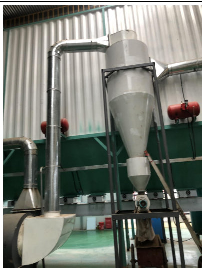
图 3-4 翻板冷却粉尘+旋风除尘器
