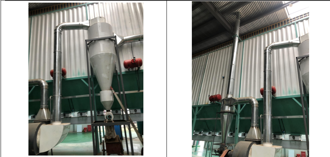
图 2-7 翻板冷却粉尘+旋风除尘器
