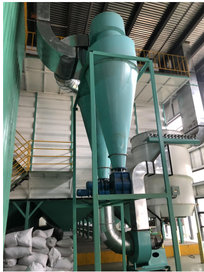
图 2-5 卸料粉尘+旋风除尘器
