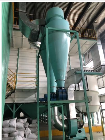
图 3-2 卸料粉尘+旋风除尘器
