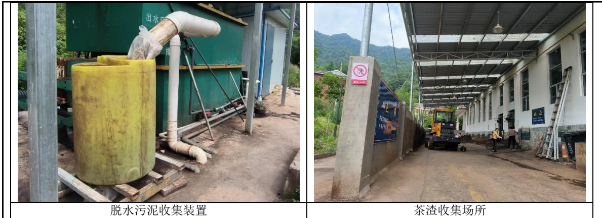
图 3-3 固废收集设施建设情况
