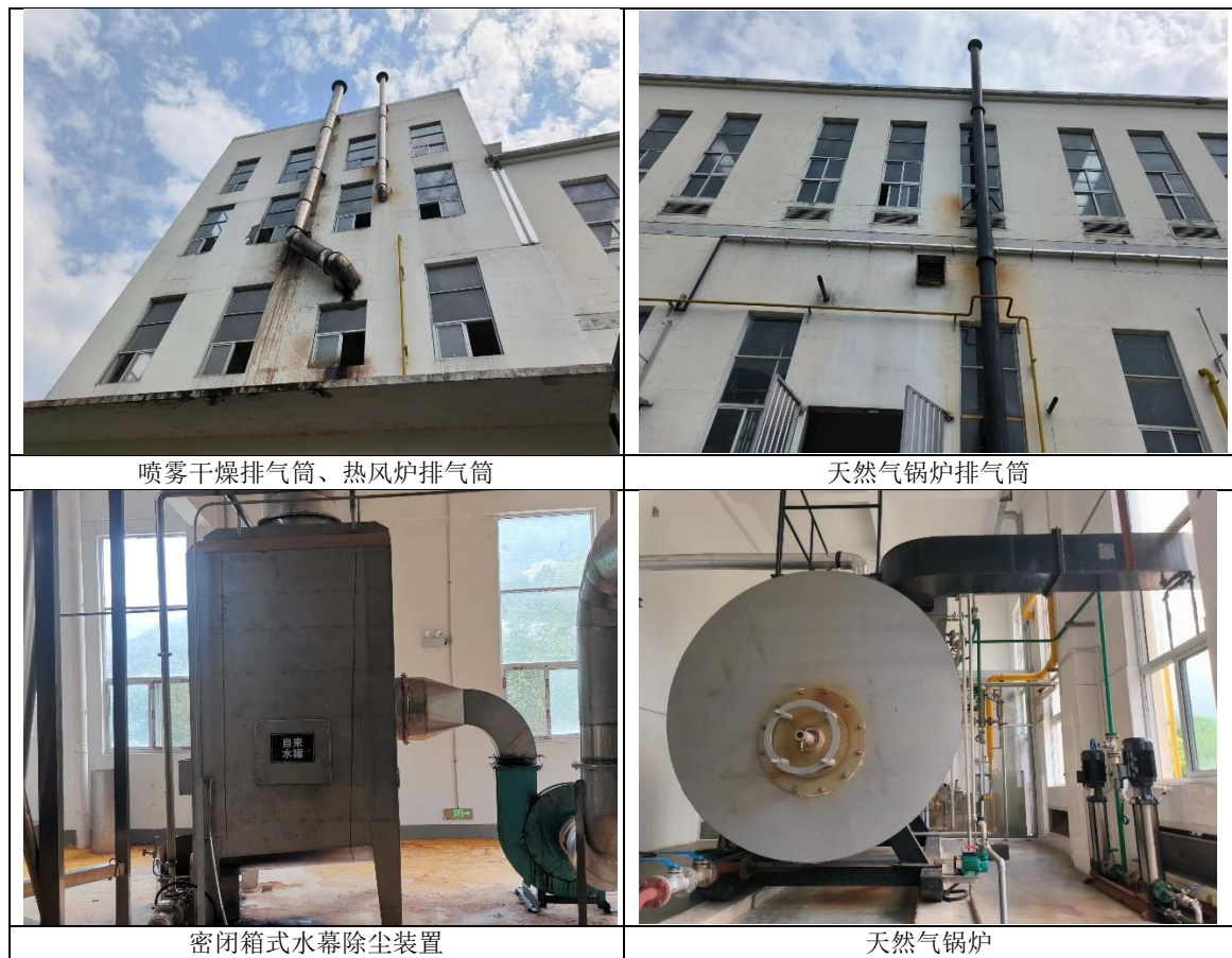
图 3-2 废气处理设施建设情况
