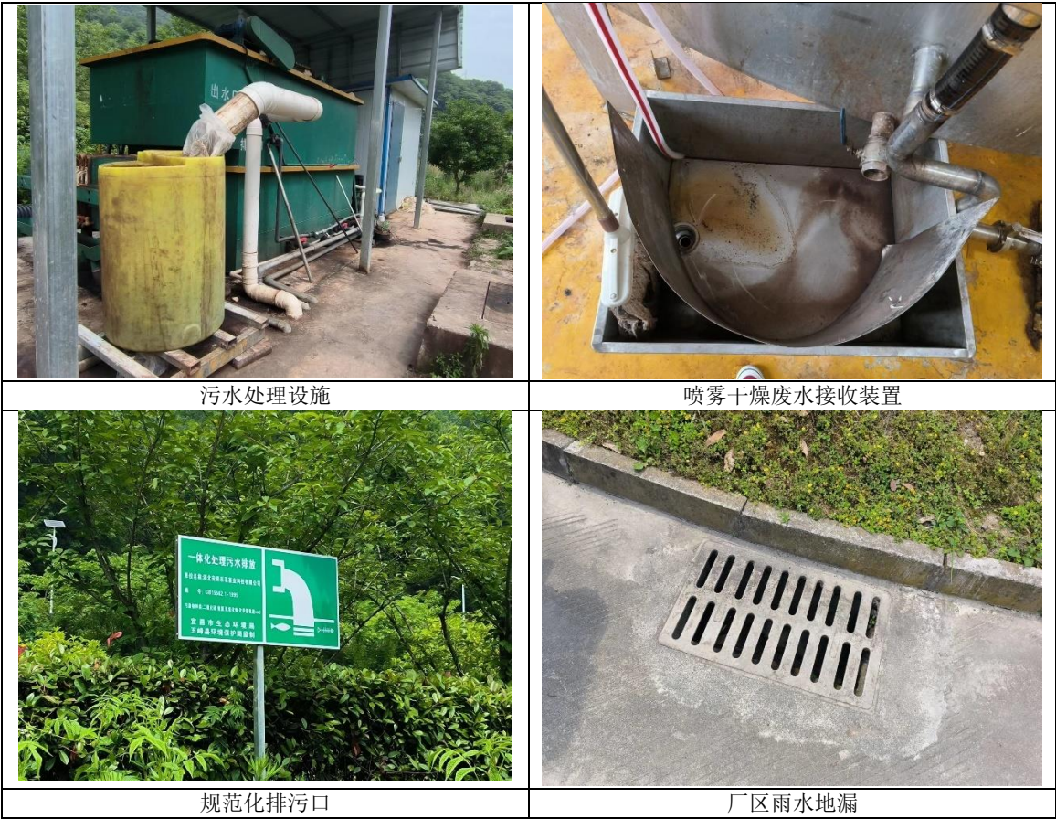
图 3-1 废水处理设施建设情况
