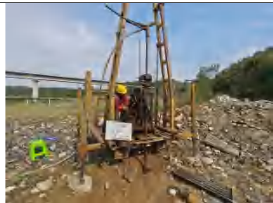
S6 土孔钻探场景
