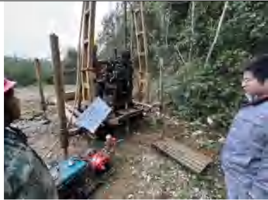
S3 土孔钻探场景
