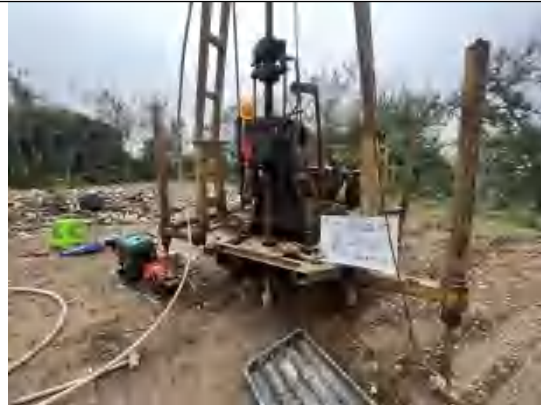
S5 土孔钻探场景
