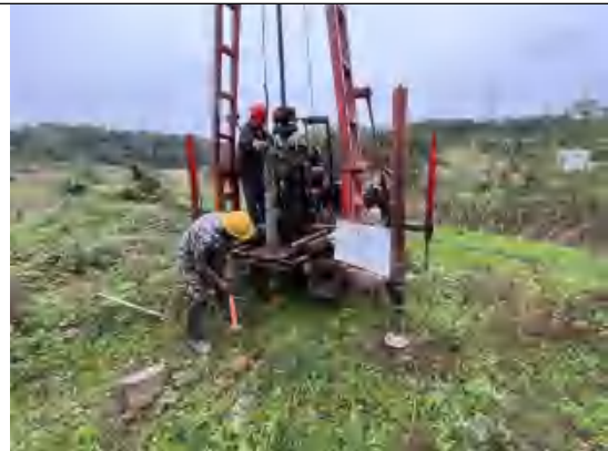
S2 土孔钻探场景
