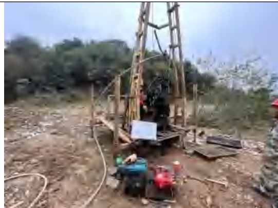
S7 土孔钻探场景
