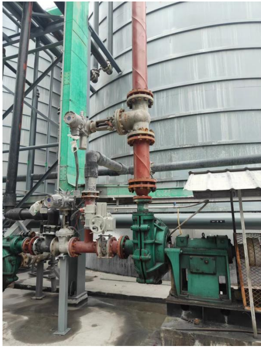
矿浆管道压力表
