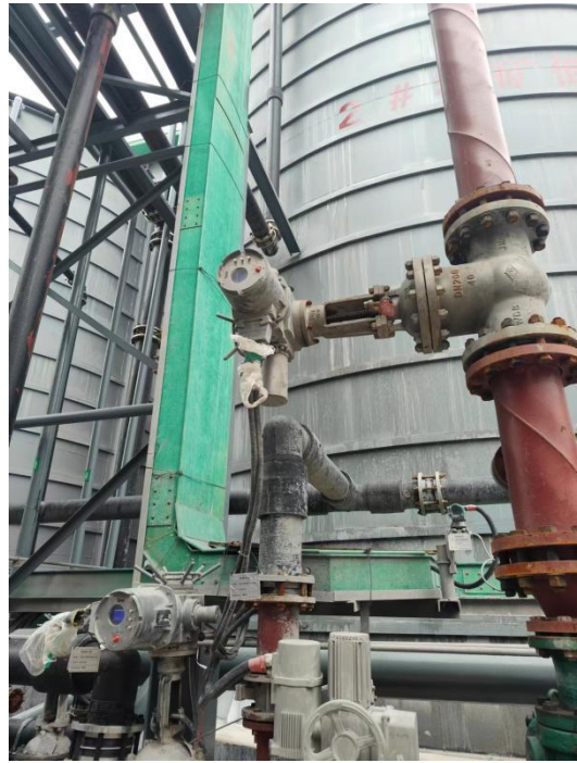
磷酸管道压力表
