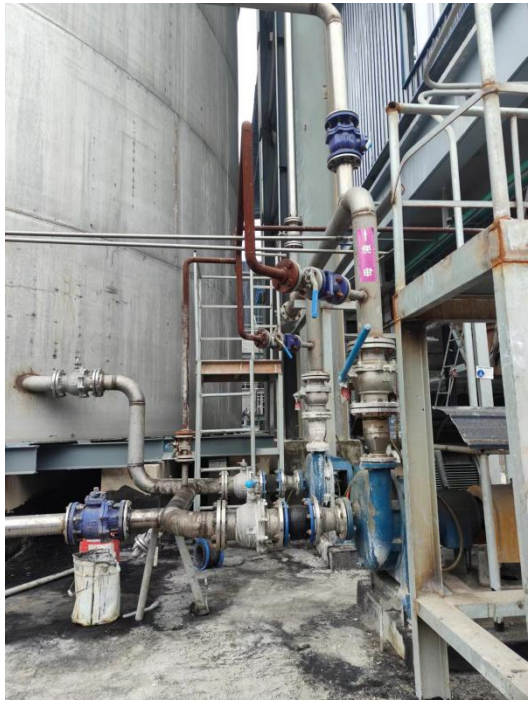
含磷废水管道压力表
