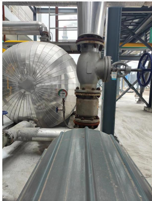
冷凝水管道压力表
