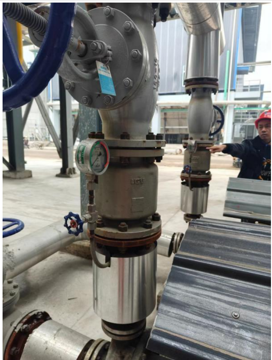
冷凝水管道压力表
