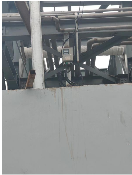
含磷废水管道压力表
