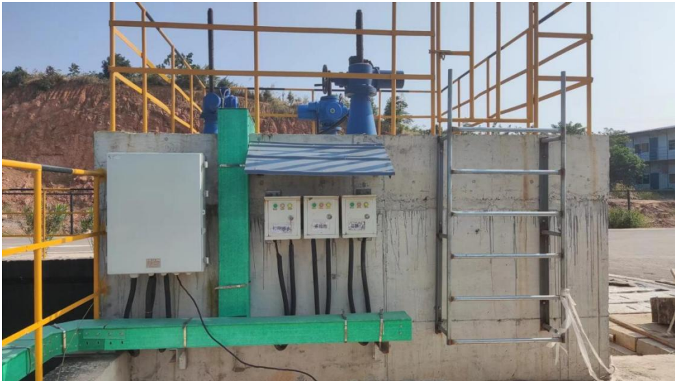
图 4-7 现场应急事故池水位及控制阀门
