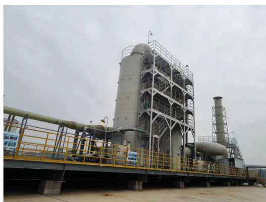
氧化塔+碱洗塔（发酵废气）
