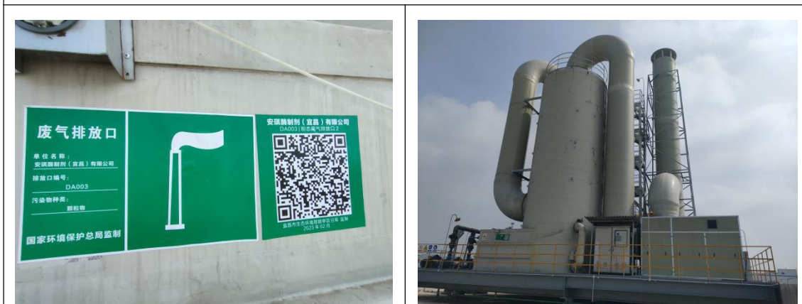
DA003 排气筒排放口标识及排气筒照片
