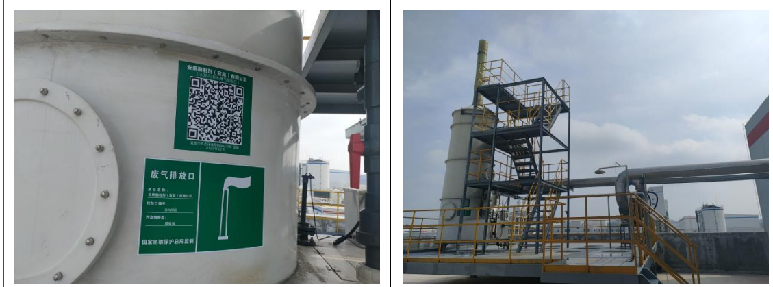
DA002 排气筒排放口标识及排气筒照片
