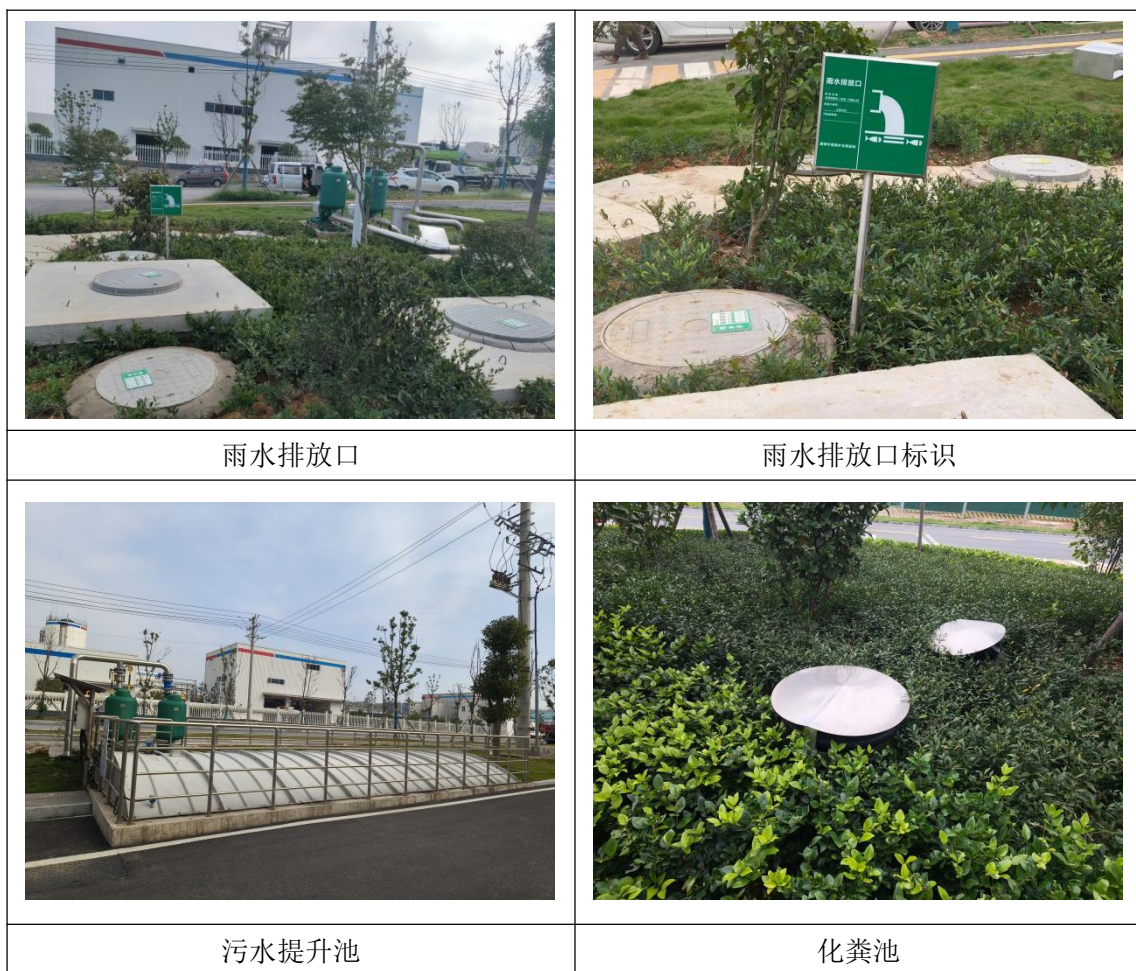
图 4.1-1 污水治理设施建设情况照片
