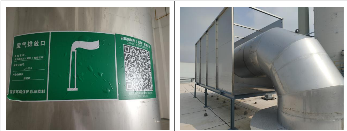
DA004 排气筒排放口标识及排气筒照片
