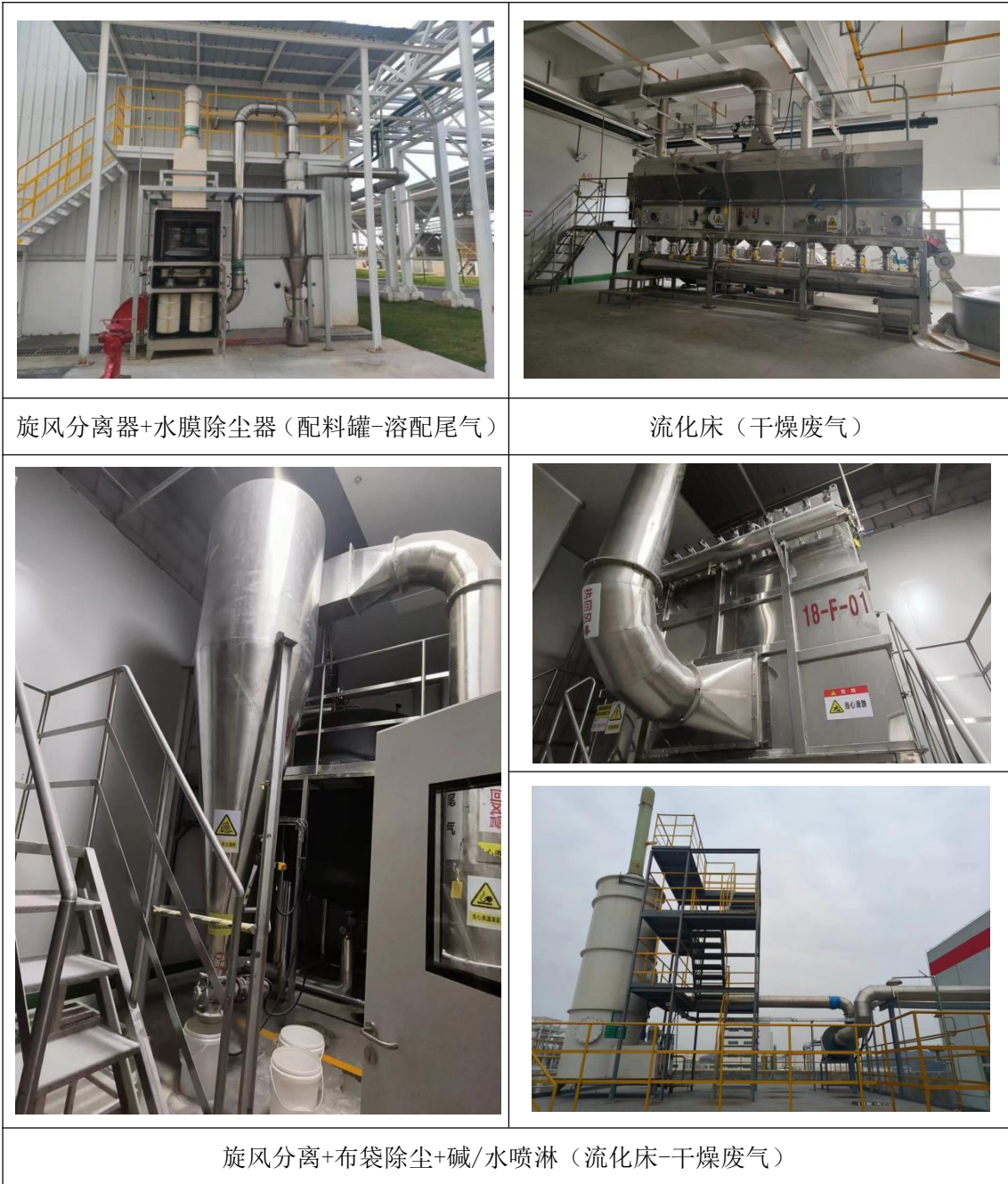
图 4.1-5 废气治理设施照片
