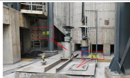
清洗水、机封水、循环水排水收集装置
