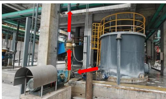
二级尾气洗涤塔废水送至磷肥厂氟硅酸钠装置
