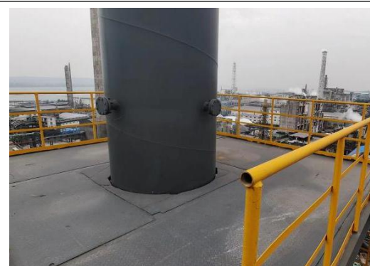
DA090 排气筒采样平台
