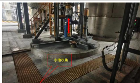
设备清洗水、机封水、管道清洗水、真空泵排水收集装置
