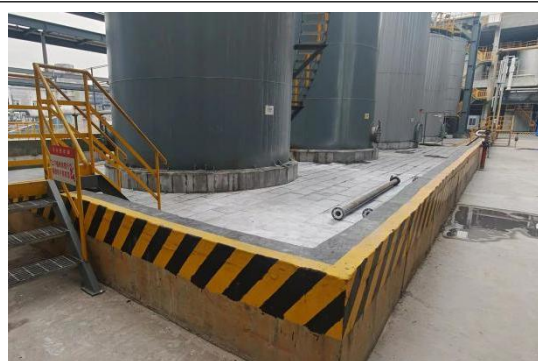
生产区罐区围堰照片（右）
