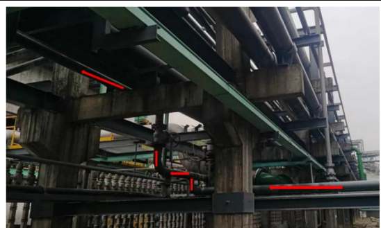
矿浆压滤滤液去往磷肥厂选矿装置
