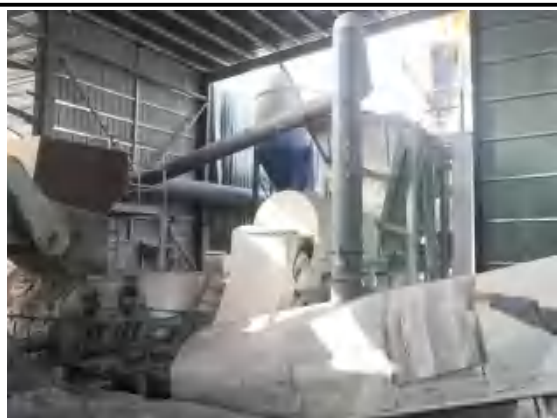
物料输送粉尘采用集气罩封闭
