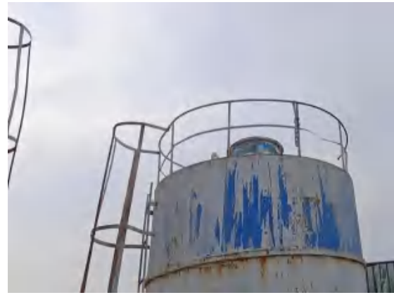
石灰罐顶收集装置
