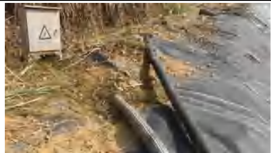
回水池输送管道
