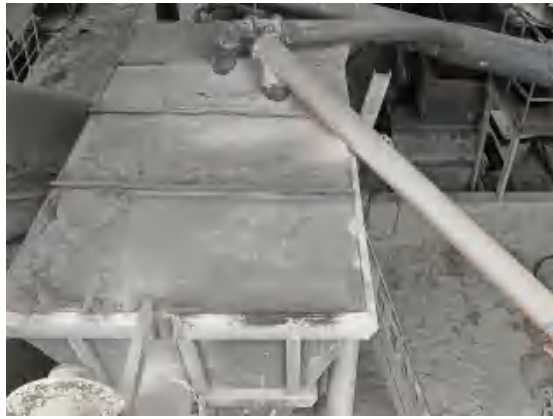
石灰罐投料口采用管道投放
