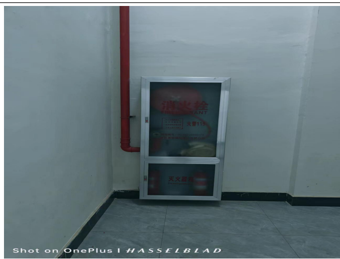
楼内消防设施
