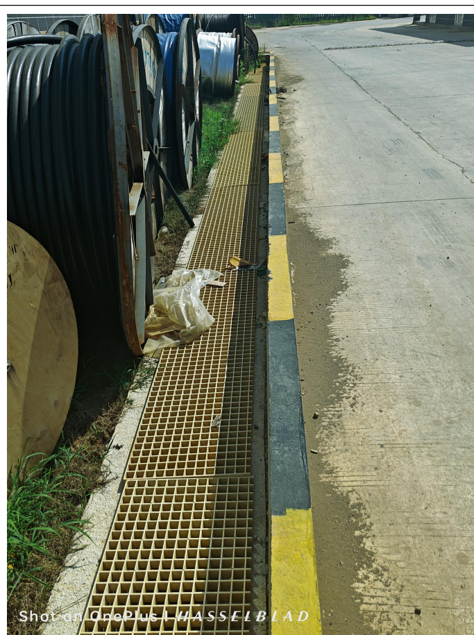
变电站四周排水沟
