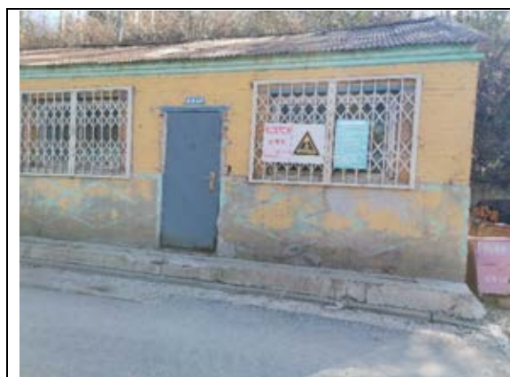
图 3.2-11 西北采区危废暂存间
