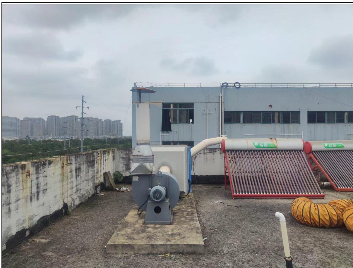
废气处置装置及排气筒建设情况
