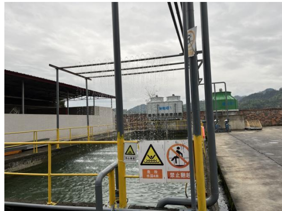
应急池及冷却塔
