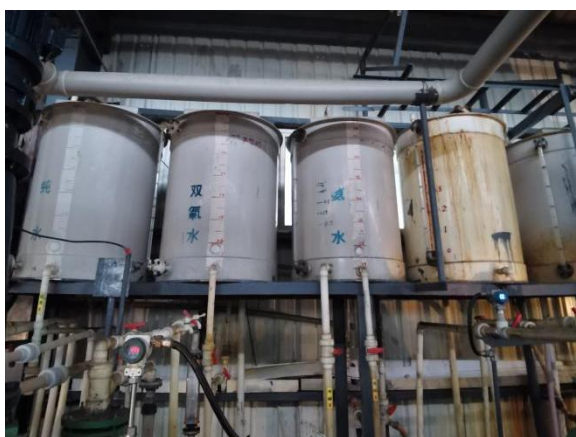
双氧水及氨水高位槽
