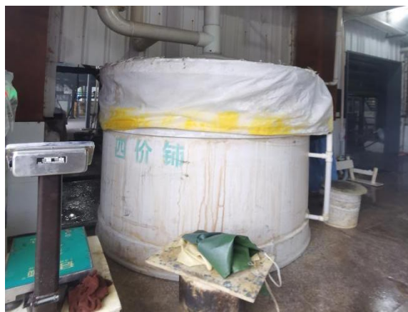
四价铈高位槽
