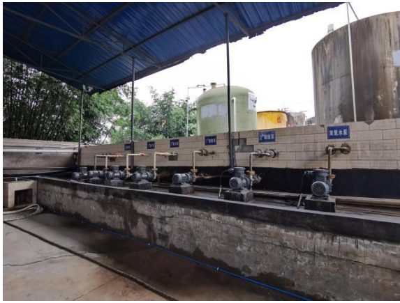
罐区输送管道
