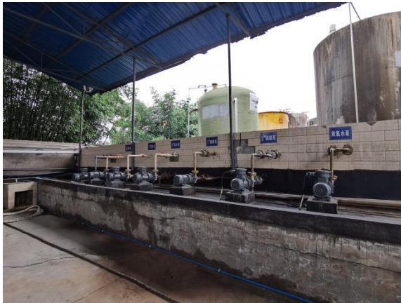
罐区输送管道
