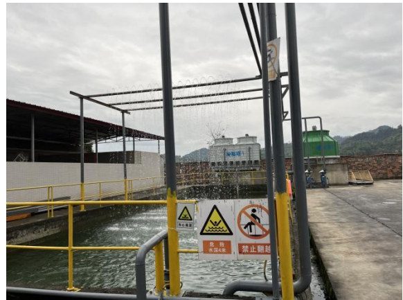
应急池及冷却塔
