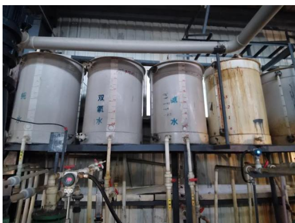
双氧水及氨水高位槽
