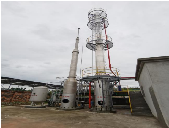
氨氮处理环保设施（未投入使用）
