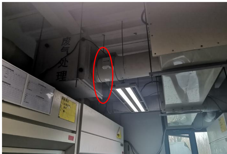
排风管道上的风机
