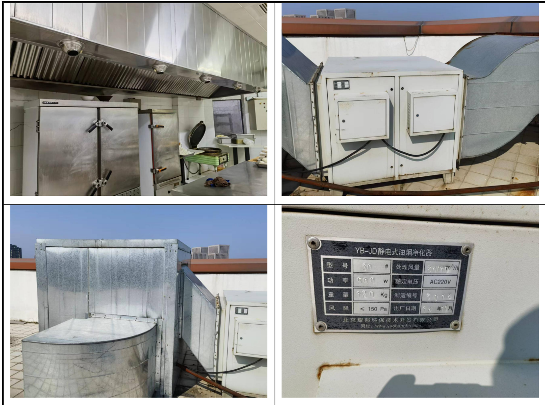
图 3-2 本项目食堂废气处理装置
