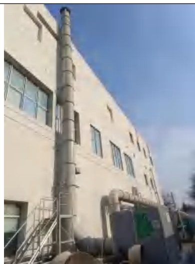
分析实验室排气口（DA014）
