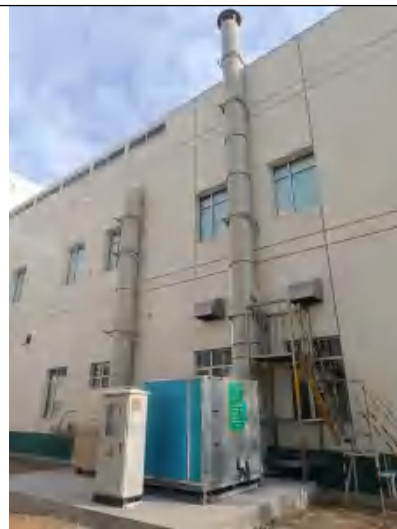
制剂实验室排气口 (DA013)
