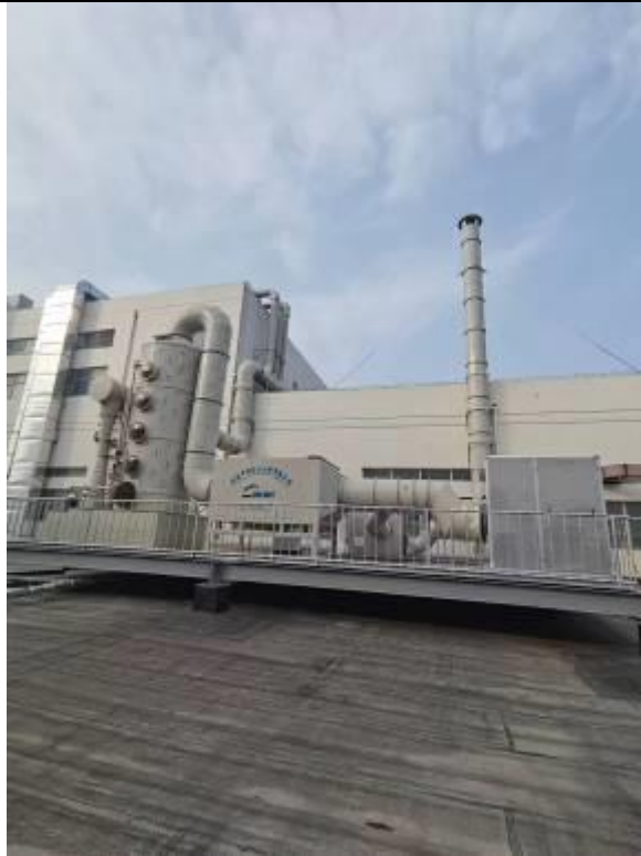
废气排气筒及排放口
