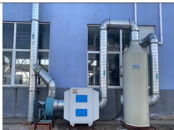
喷淋塔+活性炭吸附装置
