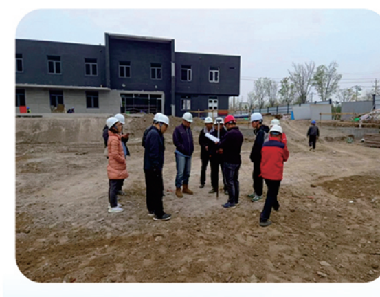
西安金风水厂一期项目单体工程变配电室地基验收工作顺利通过。
