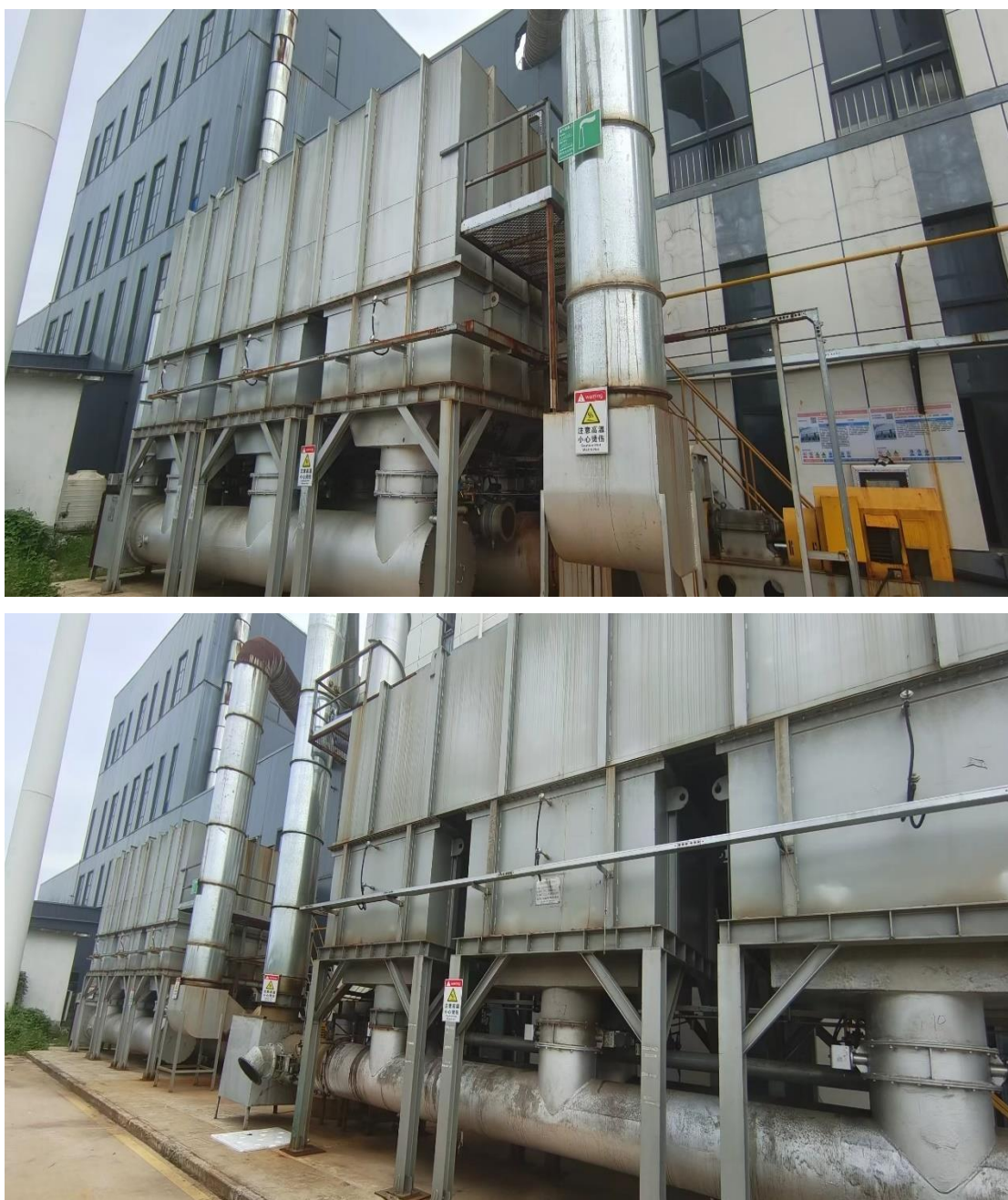
图 4-1 废气处理设施
