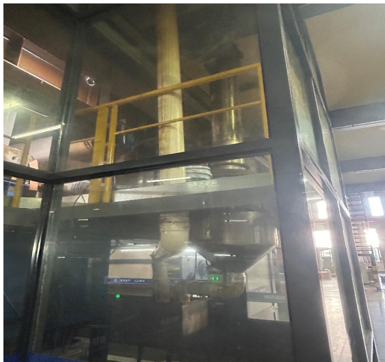
图 4-2 浸胶线废气收集
