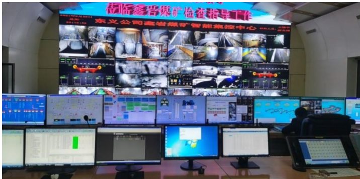
图 3-33 鑫岩煤矿智能集控中心
