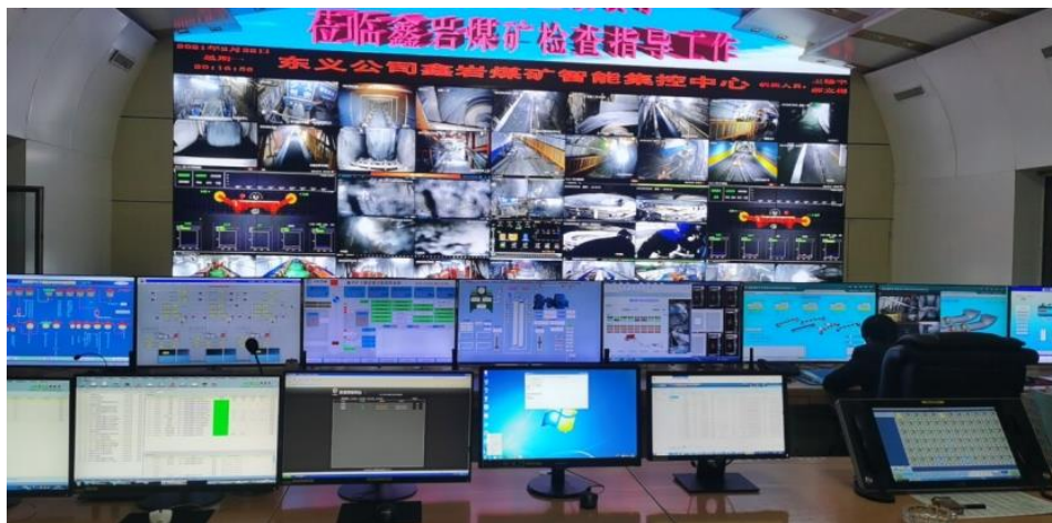
图 3-31 鑫岩煤矿智能集控中心
