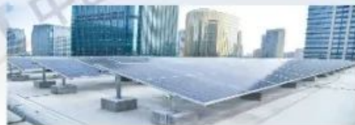
某数据中心楼顶光伏板
