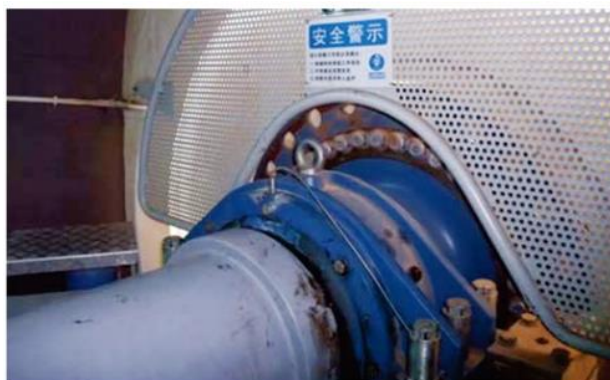
▶ 安装了在线监测系统的风机主轴承
