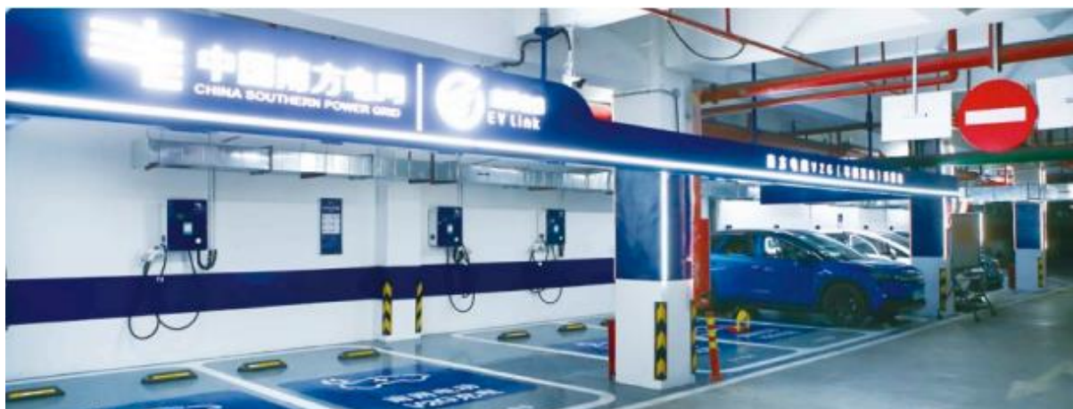
▲ 车网双向互动示范项目——龙华区民兴苑充电站
