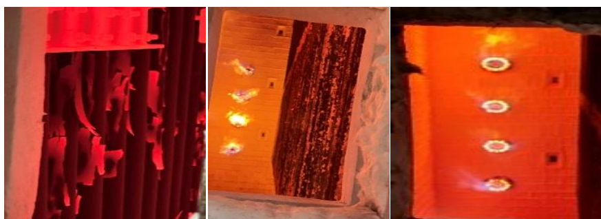
图 3：炉管表面爆皮及燃烧器更换前后燃烧情况对比
