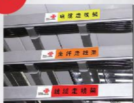
走线架设施标识
