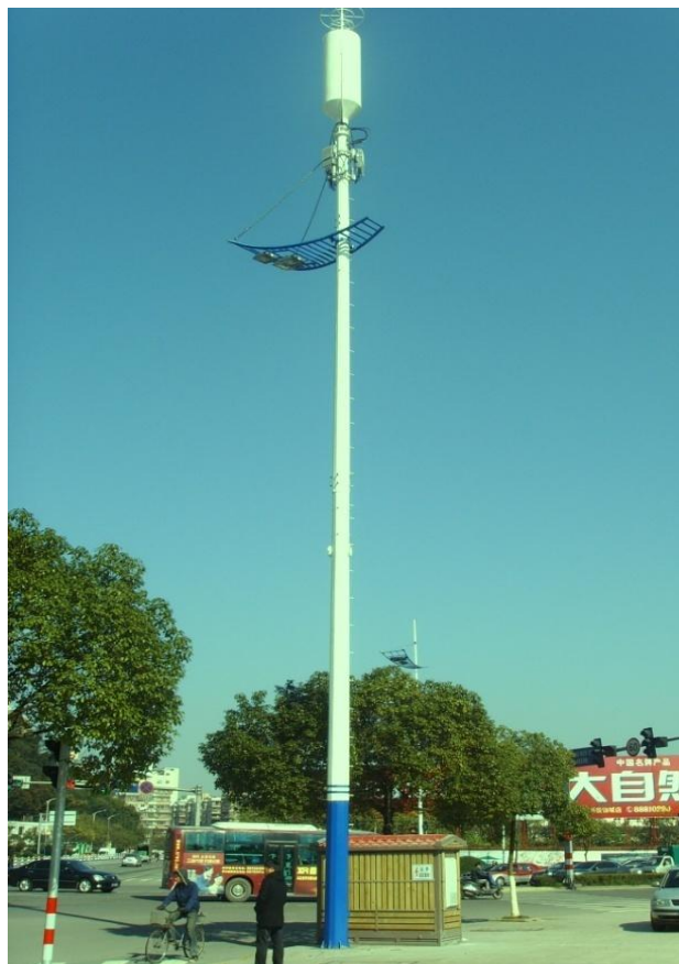
9米灯杆塔+普通机柜
