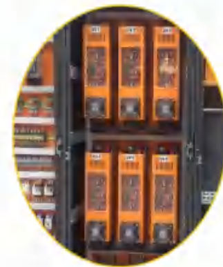
电控柜 (多灯) 内部
