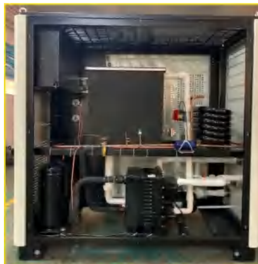
水冷式水冷系统-室内机
